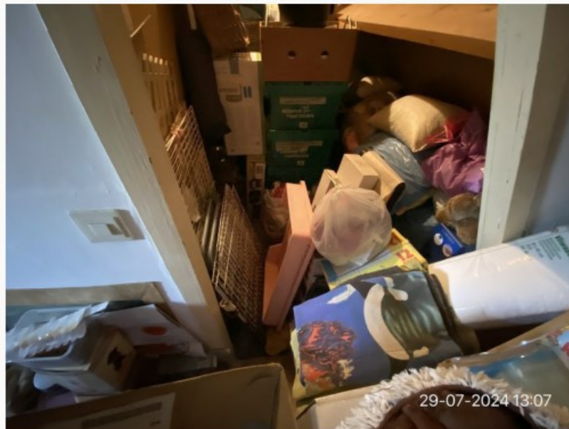
Foto 37; Zolder van de woning met vele brandgevaarlijke opslag.
