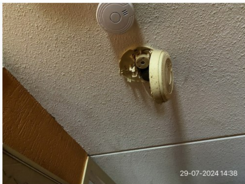
Foto 70; Rookmelder verdieping is defect, zeer brandgevaarlijk.
