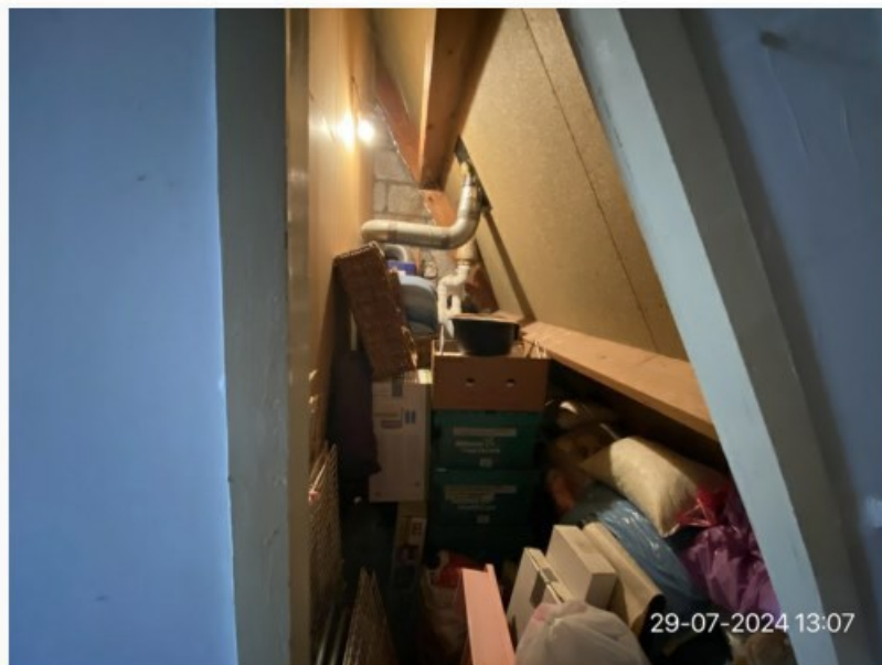
Foto 38; Zolder van de woning, cv-installatie en mechanische ventilatie niet te bereiken.
