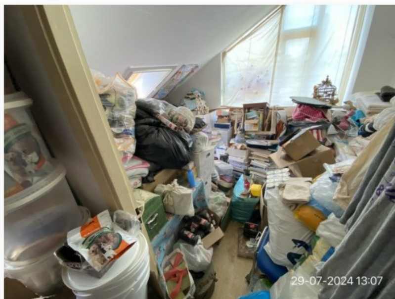
Foto 33; Zolder van de woning met vele brandgevaarlijke opslag.
