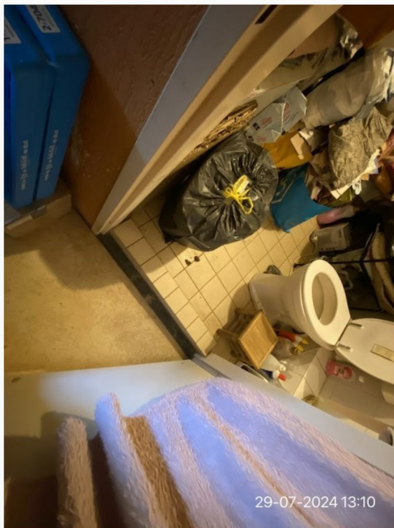
Foto 50; Badkamer eerste verdieping, douche niet te gebruiken door opslag.
