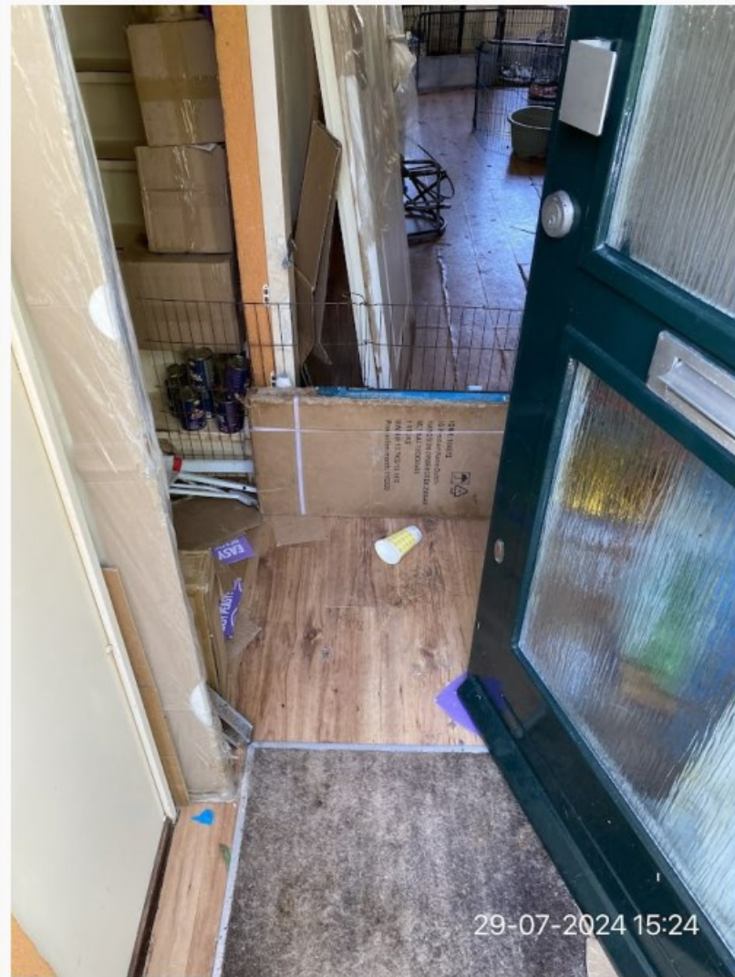
Foto 76; Voordeur, deur hal woonkamer niet aanwezig.
